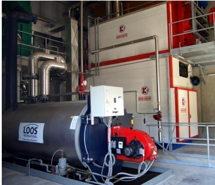
100% Ausfallsreserve durch Ölkessel
