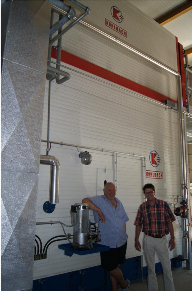
2MW Hackgutkessel österr. Heiztechnik mit Weltformat
