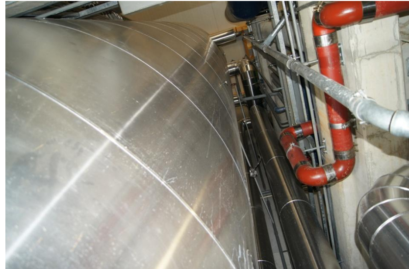
60.000l Pufferspeicher gleicht Leistungsschwankungen und kurze Betriebsunterbrechnungen aus
